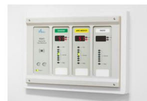
Fuente: INGEMEDICA. Central de gases
